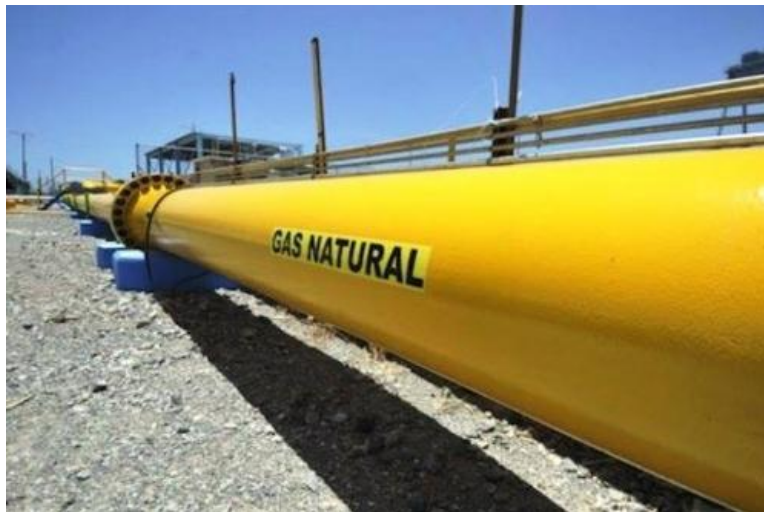
Figura 7. Imatge d'un gaseoducte 9
