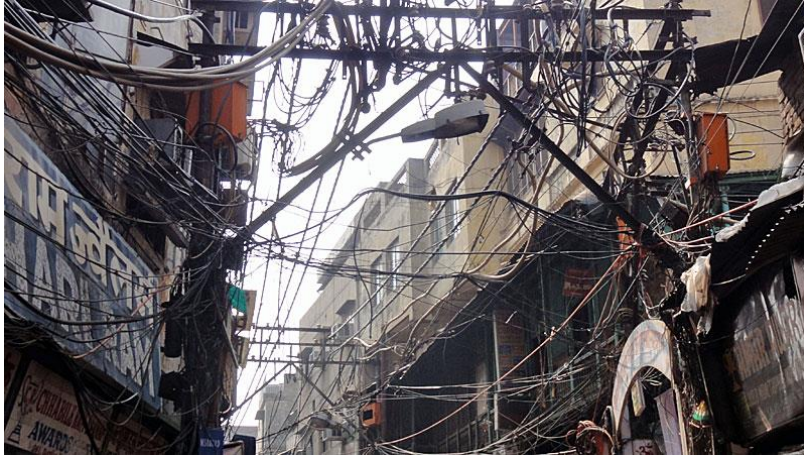
CABLES ELÈCTRICS A LA ÍNDIA
