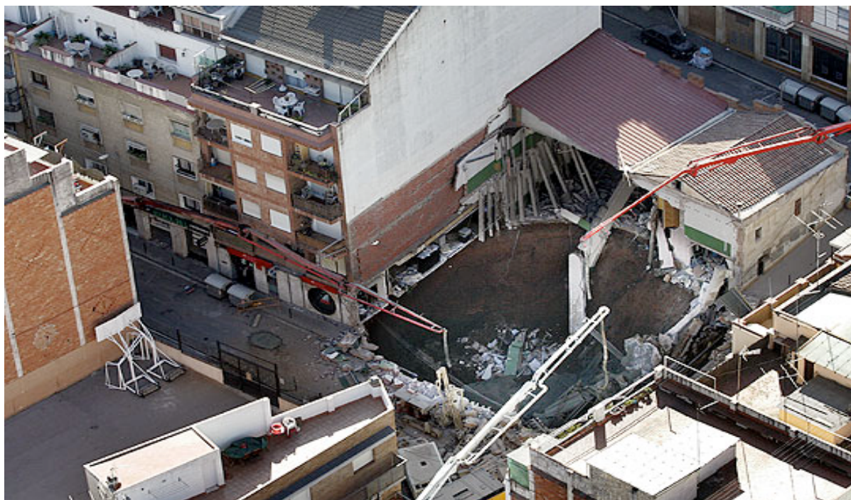
Enfonsament al carrer Calafell
