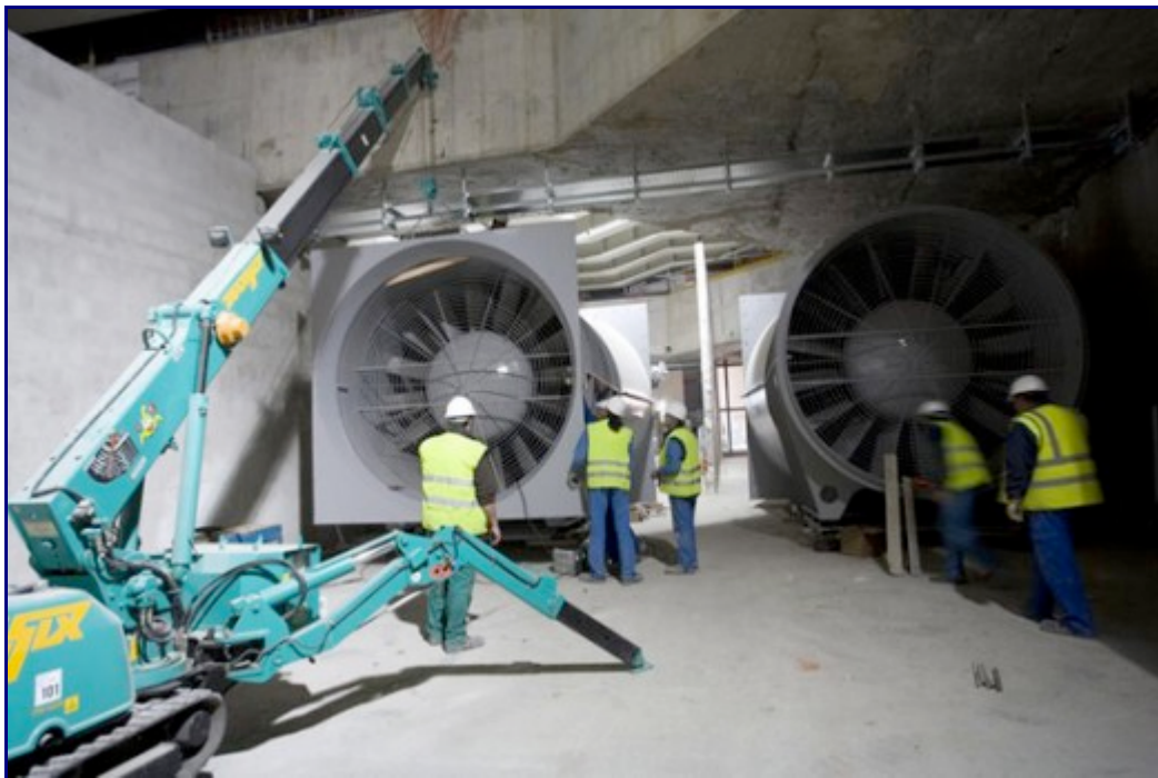
Central de ventilació
