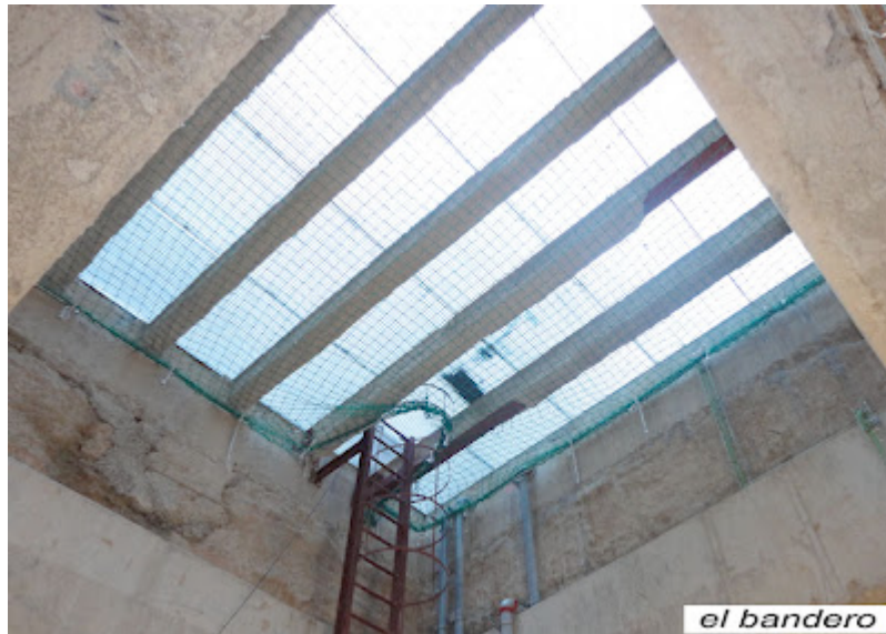
Reixa de ventilació del metro de Barcelona
