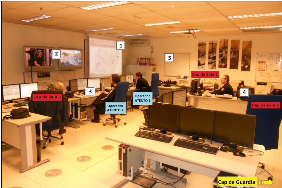
Fig 8. Vista de la sala de bombers al CGE
