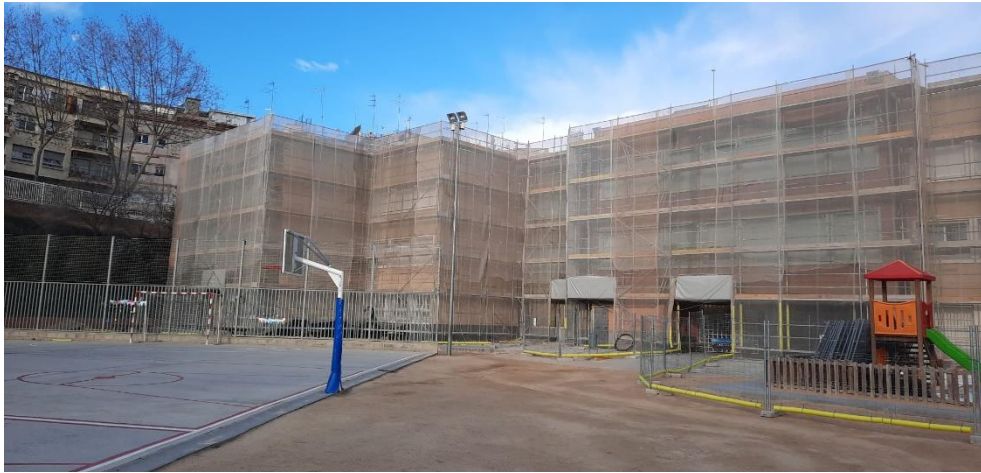
Imatge de les obres a la façana de l'Escola Ramon Berenguer III
