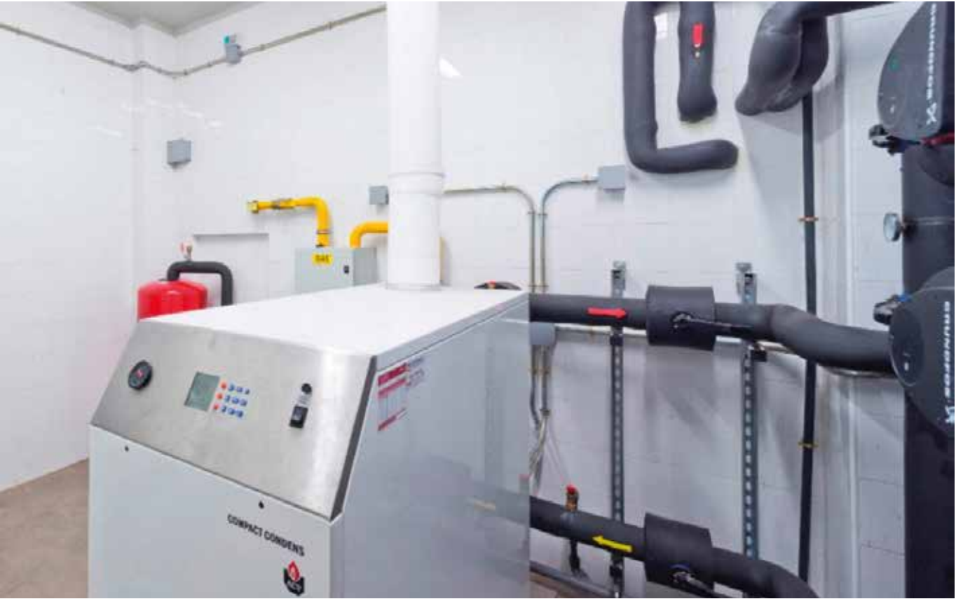
Sala de calderes de l’Escola Marinada
